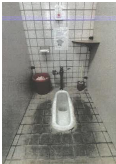
說明：便器老舊且踏板損壞
