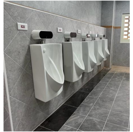
說明：新設便器美觀且省水
